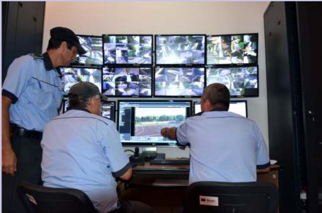
Proiect: Achiziționarea și instalarea de sisteme de supraveghere pentru creșterea siguranței publice și prevenirea criminalității Beneficiar: UAT ORAȘUL HÂRȘOVA
