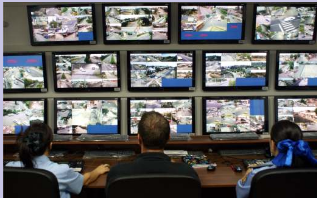
Proiect: Creșterea siguranței și prevenirea criminalității în zona de acțiune a municipiului Buzău, prin achiziționarea de echipamente specifice și amenajarea unui centru de supraveghere Beneficiar: UAT MUNICIPIUL BUZĂU
